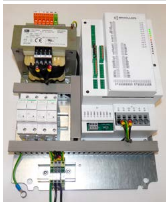
SZAFKA STEROWNICZA NA STALOWEJ PŁYTCIE MONTAŻOWEJ
